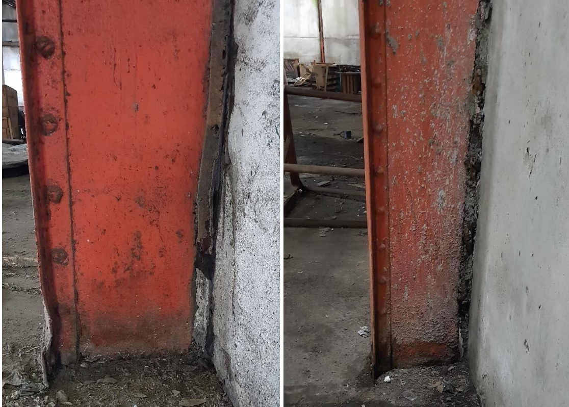
Figura 12 – Pilares dos pórticos metálicos extremamente danificado
