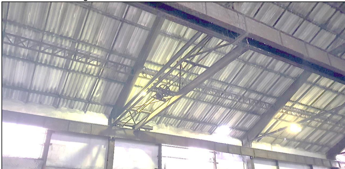
Figura 10 – Ponte rolante e estrutura metálica
