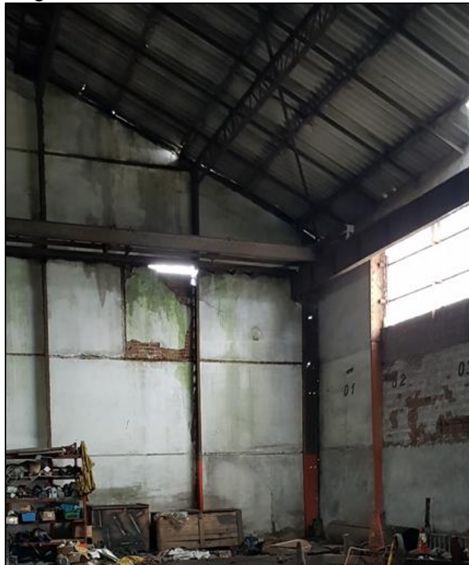
Figura 7 – Danos estruturais e no fechamento
