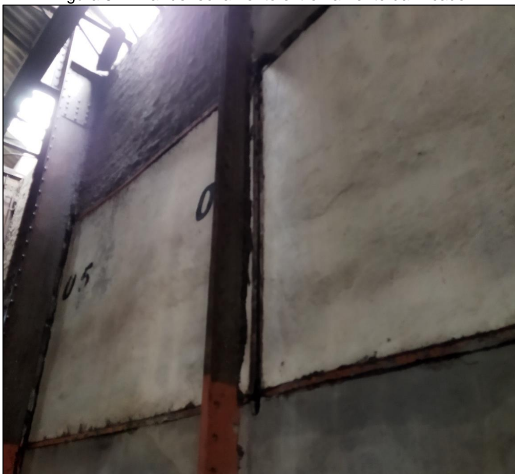
Figura 8 – Pilar de fechamento extremamente danificado.
